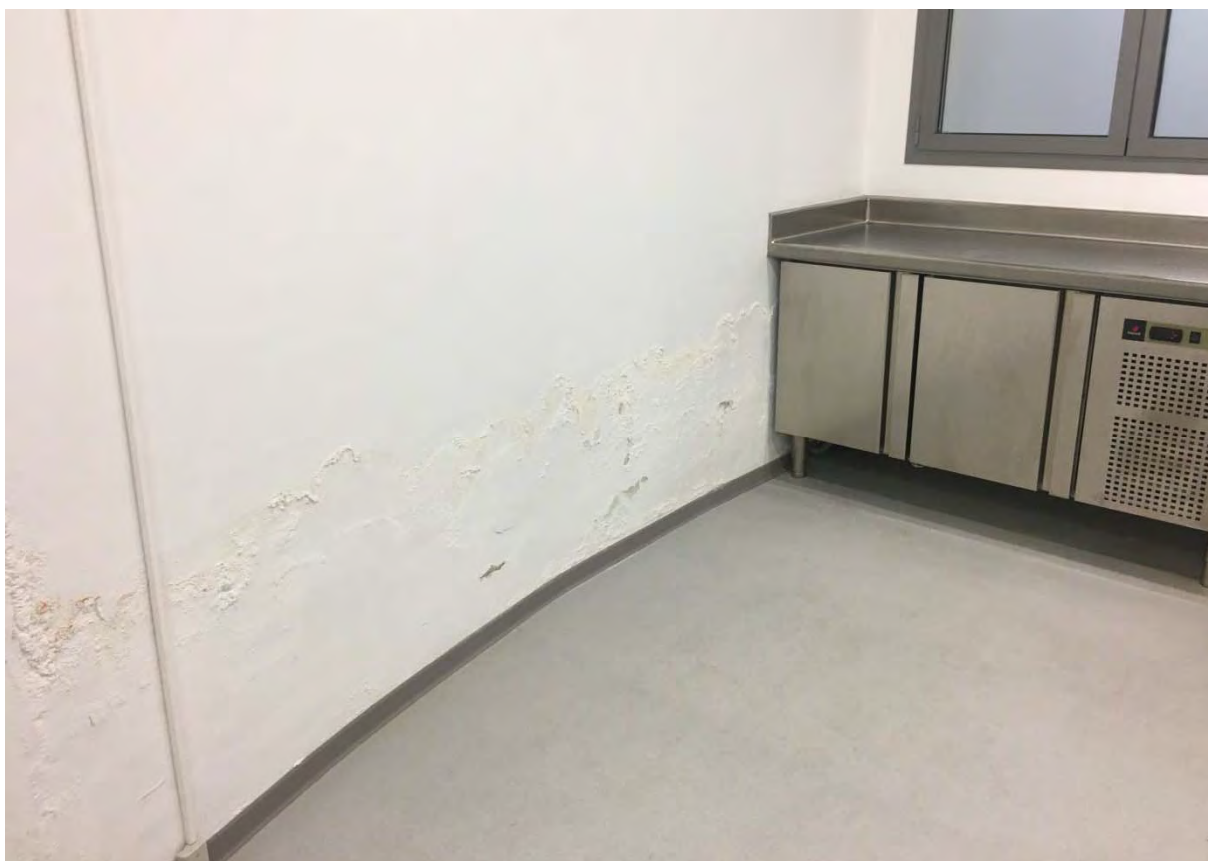
ZONA 5_3 – CUARTO PREPARACION CUARTO FRIO.
