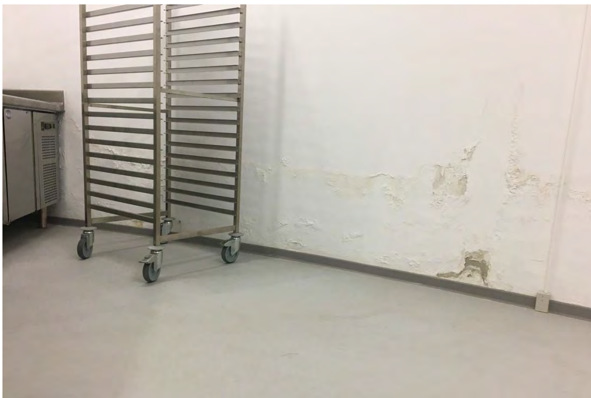
ZONA 5_2 – CUARTO PREPARACION CUARTO FRIO.
