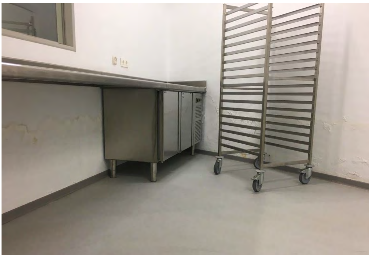
ZONA 5_1 – CUARTO PREPARACION CUARTO FRIO.
