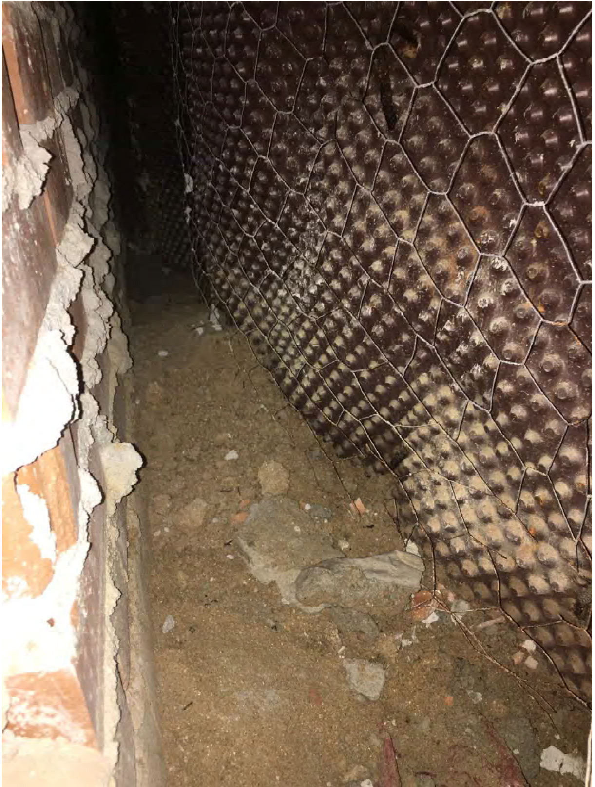
ZONA 3 – LATERAL IZQUIERDO DE LA CALA DEL TABIQUE DE CÁMARA BUFA
