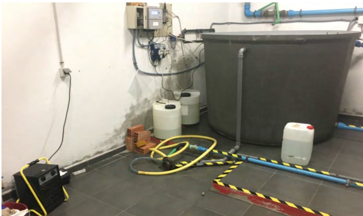
ZONA 2 – CUARTO INSTALACIONES Y AGUA FRÍA SANITARIA.
